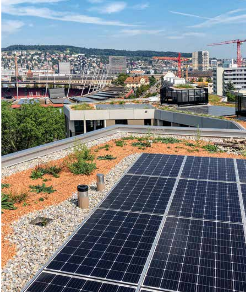
Die Siedlungsgenossenschaft Eigengrund geht wie andere Baugenossenschaften freiwillig über die Vorgaben der MuKEN hinaus. Sie setzt wo immer möglich auf erneuerbare Energien – bei Neubauten wie dem Ersatzbau Letziggraben, der unter anderem PV-Anlagen und Wärmepumpen nutzt und die Anforderungen Minergie-P-Eco sowie SNBS erfüllt...
