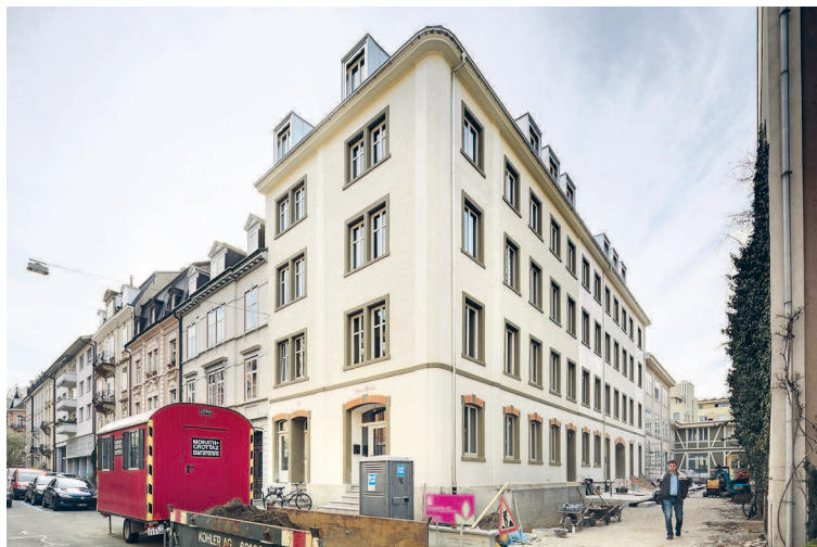
Der Umbau des ehemaligen Leber Papier-Gebäudes an der Reichensteinerstrasse 14 ist bald fertig. Es entstand eine Oase für gemeinsames Wohnen.
